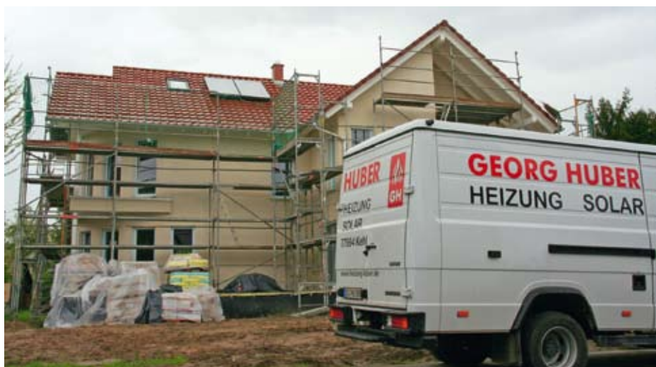
86 der 142 Solarthermieanlagen montierte der Heizungsfachbetrieb Georg Huber auf den Dächern des Fertighaus-Herstellers Weber Haus, mit dem schon seit langem eine gute Zusammenarbeit besteht
